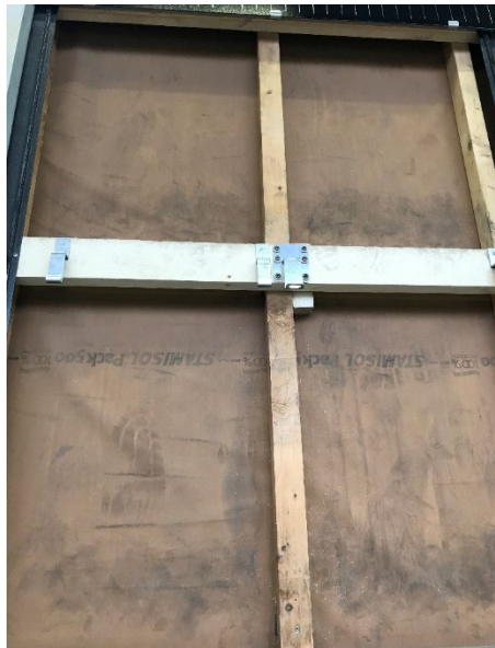
Abbildung 13 Übersichtsfoto der montierten Anschlageneinrichtung
